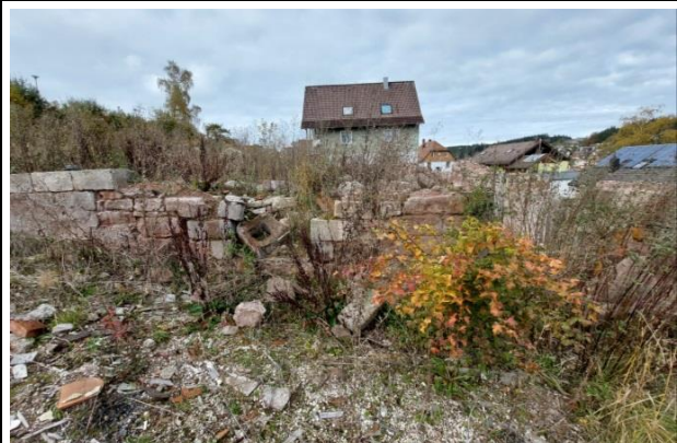
Mauerreste, Bauschutt und Gehölzaufwuchs (Foto: faktorgruen, 26.10.2021)
